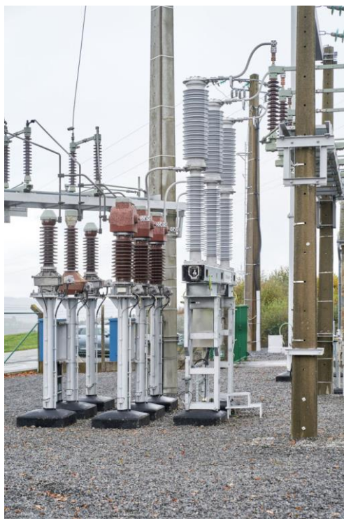
Figure 2.3 Premier disjoncteur sans SF6 d'une nouvelle génération sur le réseau 70kV d'Elia (sous-station 70kV de Marcourt)
