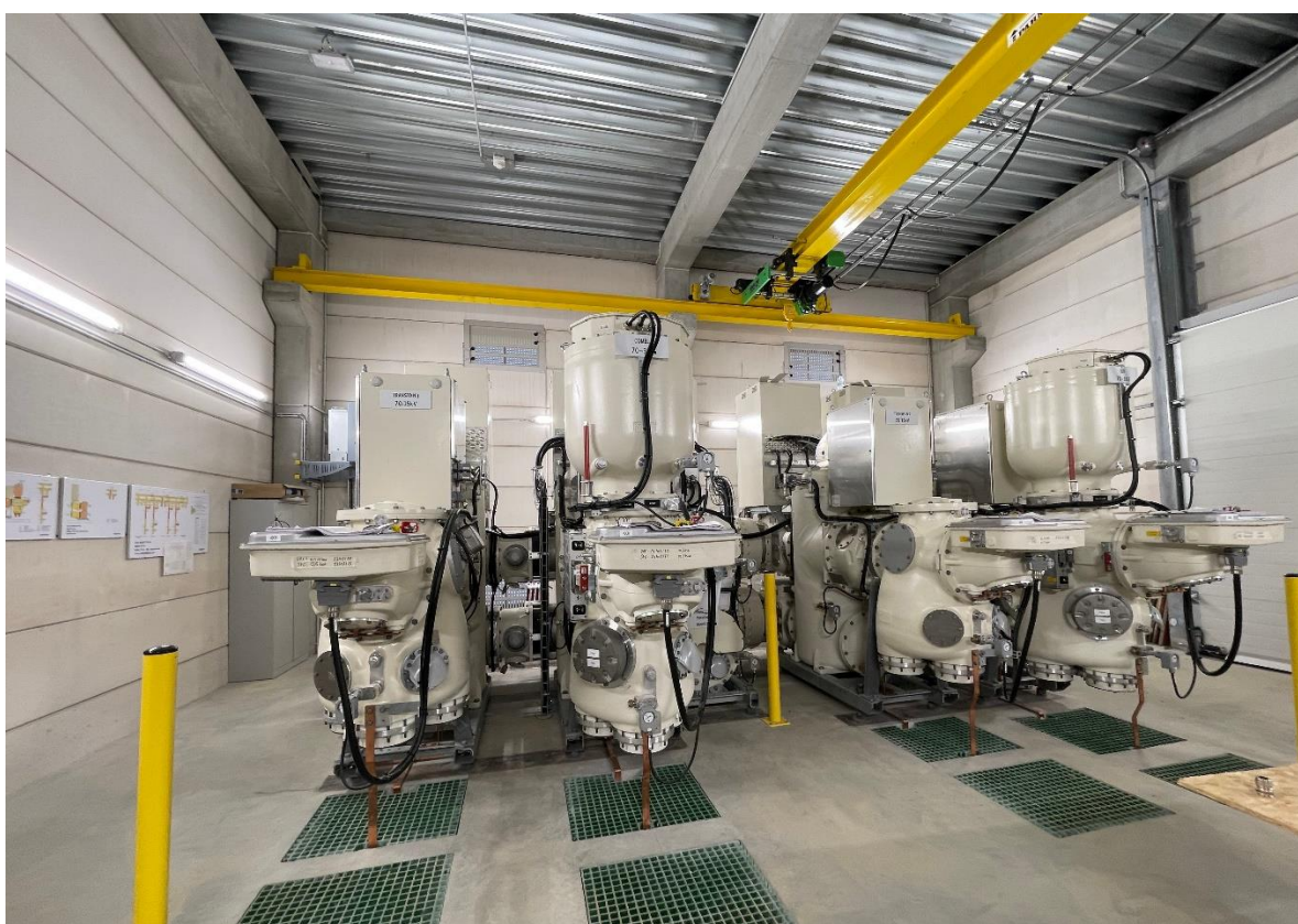
Figure 2.2 Sous-station GIS de Bomal
